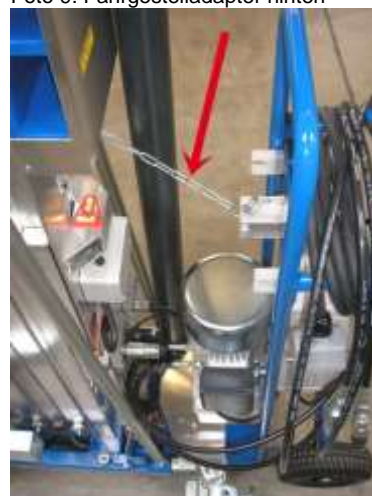
Foto 11: Versorgungseinheit mit Sicherungskette gesichert
