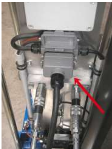
Foto 28: Elektrischer Anschluss Mast-, Versorgungseinheit
