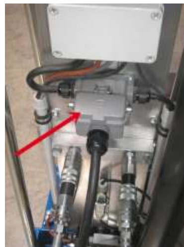
Foto 29: Sicherungsbügel am elektrischen Anschluss
