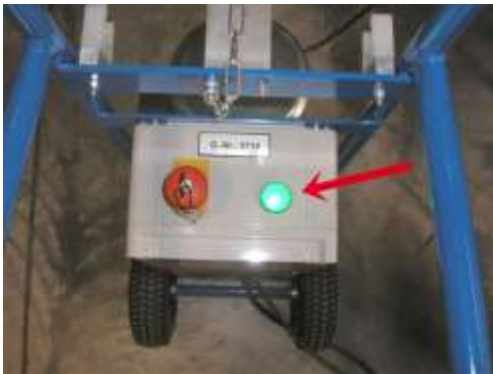
Foto 42: Leuchtanzeige im Schaltkasten
